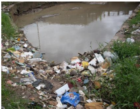
Figura 5: Situação encontrada no Ponto 4. (Autor: Edilson Cavalcante Jr., 2011)
