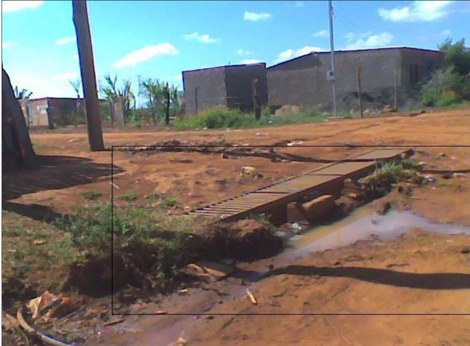
Foto 11: A falta de estrutura adequada deixa o esgoto a céu aberto. Autor: PEREIRA, G. A. S. (2009)
