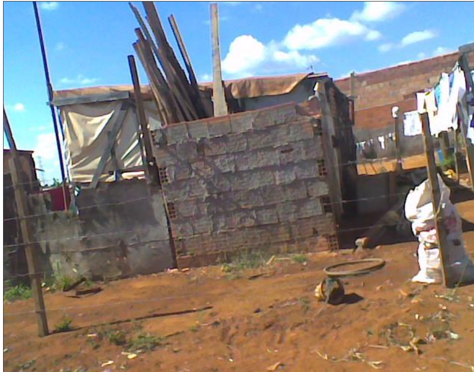
Foto 6: Casa revestida com tijolos complementadas com lonas e madeirites. Autor: PEREIRA, G. A. S. (2009)
