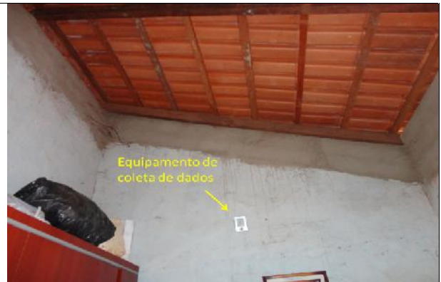
Fig. 2 – Localização do equipamento de coleta de dados (Termo-higrômetro) na residência com telha Plan.
