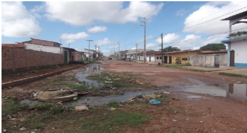
Foto 02: Esgoto in natura , 29/06/2011, Conj. Maiobão.
